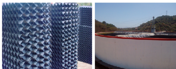
Fig. 1. Medio filtrante y filtro percolador en PTAR “El Punto”.
